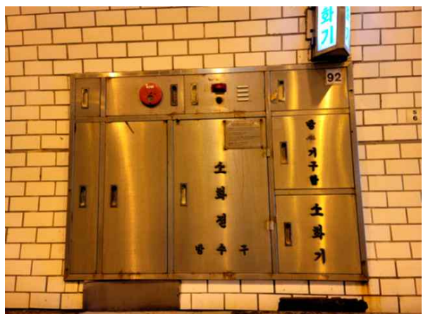
소화시설 및 비상전화 전경
